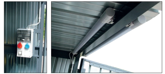
Elektrisches System und Beleuchtung
